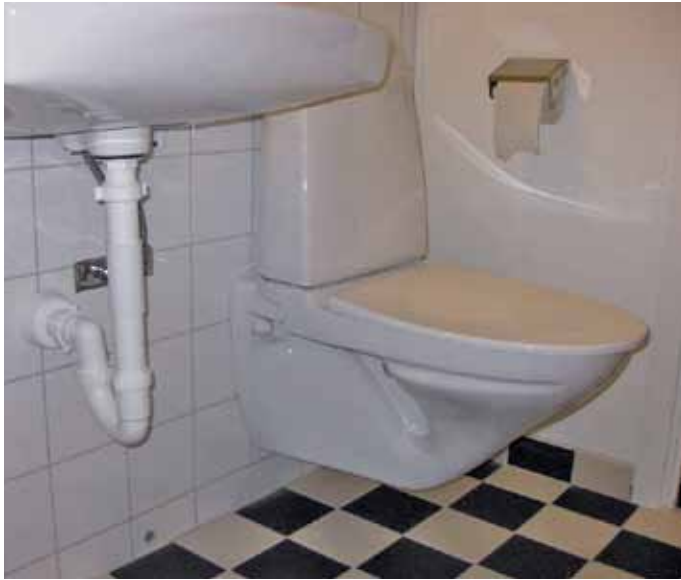
– Vad döljer sig i väggen bakom toalettstolen?
