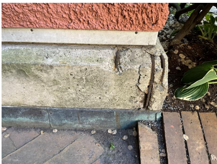
Skador i betongsockeln.
