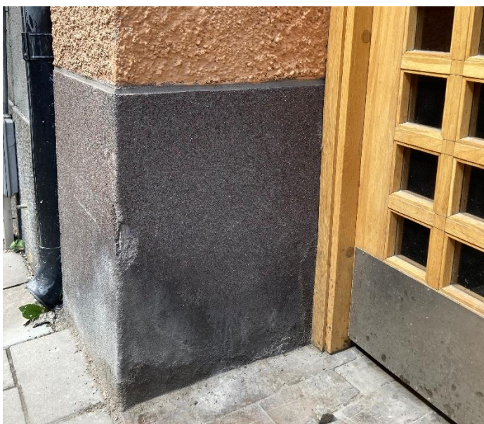
Skador på sockel.
