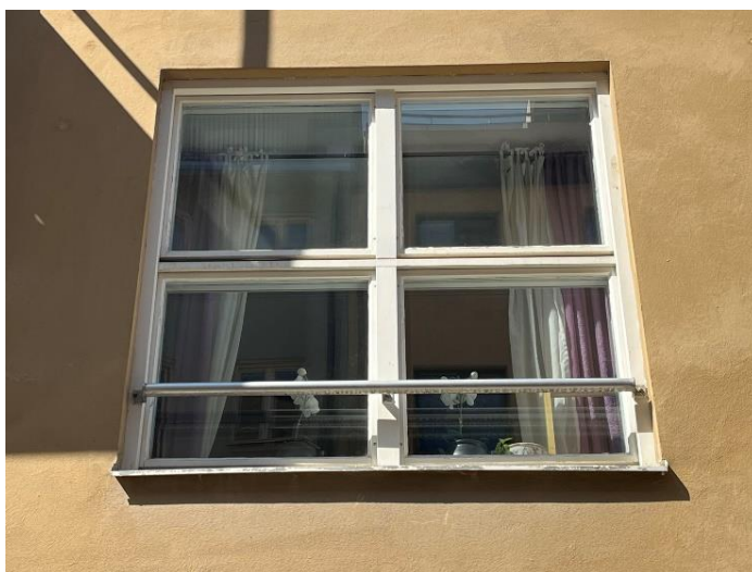
Fönsterparti med fallskydd.
